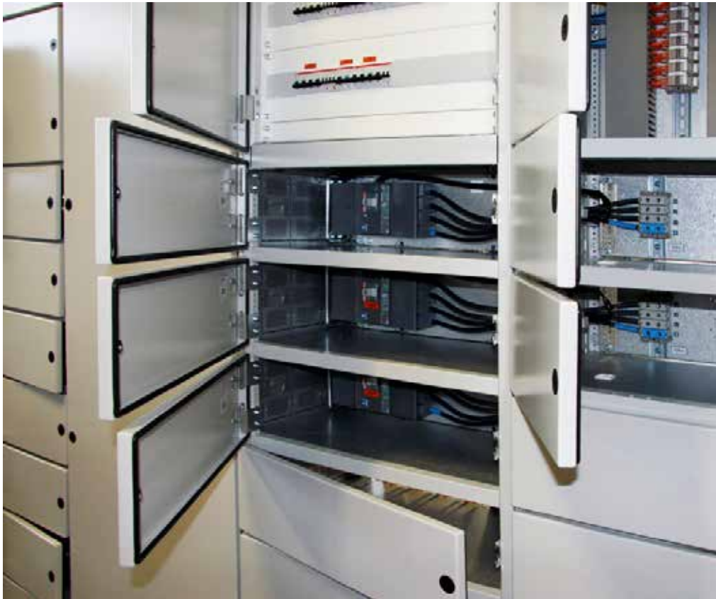
Fordelingstavle i utførelse form 4b
