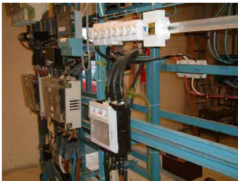
Eldre tavle med sikringsskillebryter
